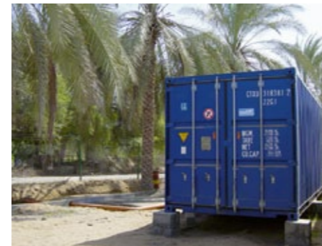
Conteneur: Traitement d'eau à Oman
